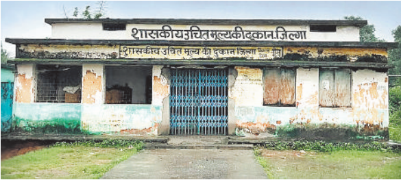
जर्जर पीडीएस भवन जहां से होता है खाद्यान्न का वितरण।
